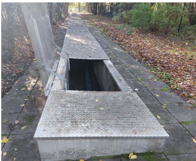
Infiltrationsanlage des Wasserverbandes Hessisches Ried im Wald
