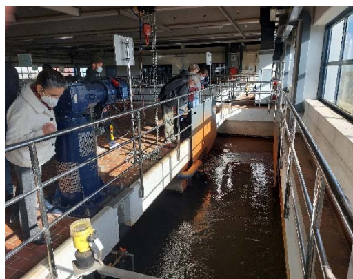
Aufbereitung des Rheinwassers
